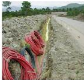
Première intervention brutale: la pose du câble de liaison du complexe éolien.
